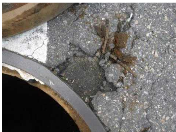
주변포장 균열 및 비산
