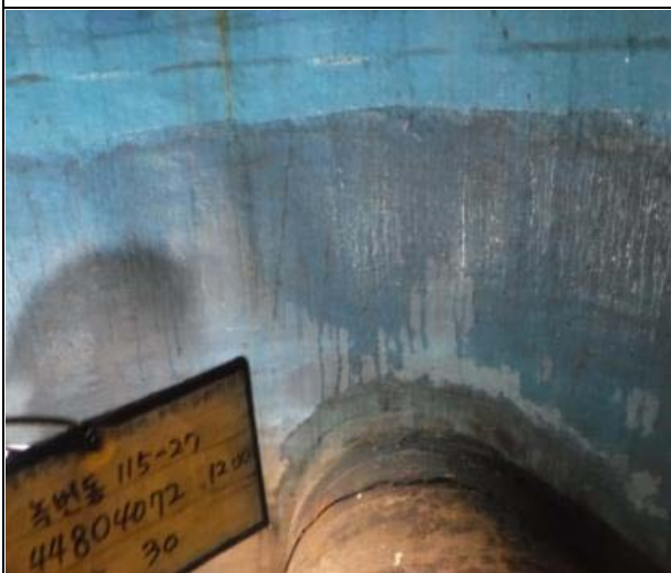
내부 벽체 균열
