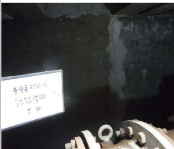
내부 벽체 균열
