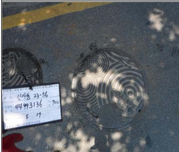
외부 포장 균열
