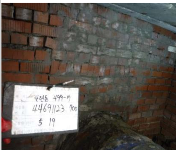
내부 벽체 균열
