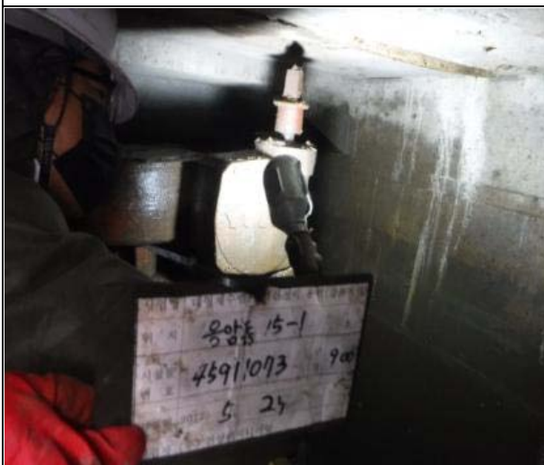
내부 벽체 균열
