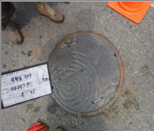
외부 포장 균열
