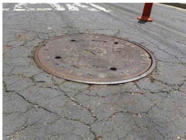
주변포장 망상균열 및 비산
