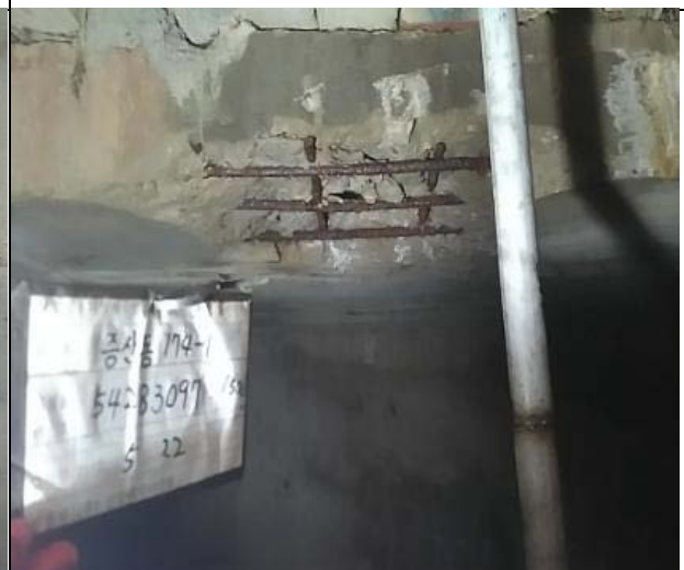
상부 철근 노출
