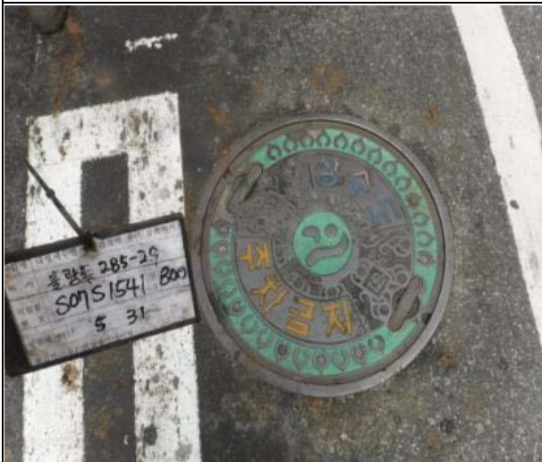
외부 포장 균열
