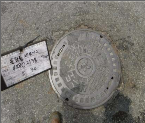
외부 포장 균열
