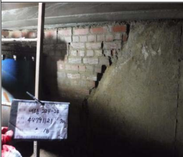
내부 벽체 균열
