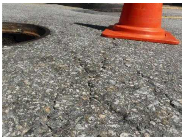
균열 및 비산
