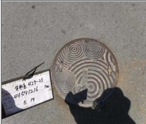
외부 포장 균열
