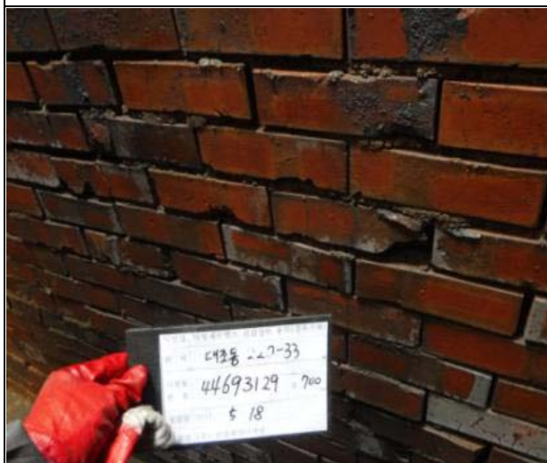
내부 벽체 균열
