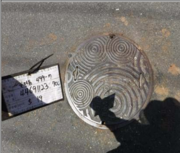
외부 포장 균열
