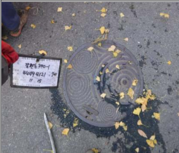
외부 포장 균열
