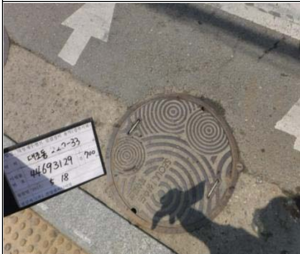
외부 포장 균열
