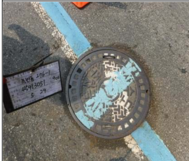
외부 포장 균열
