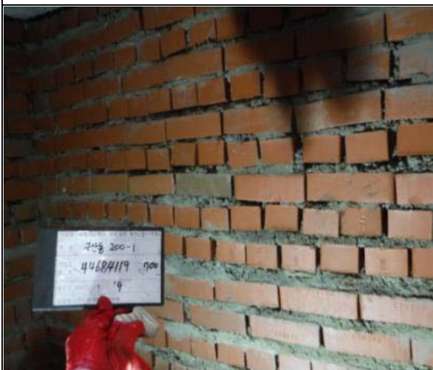
내부 벽체 균열
