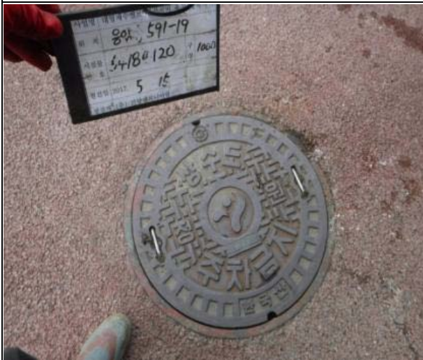
외부 포장 균열
