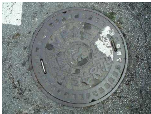
균열 및 비산
