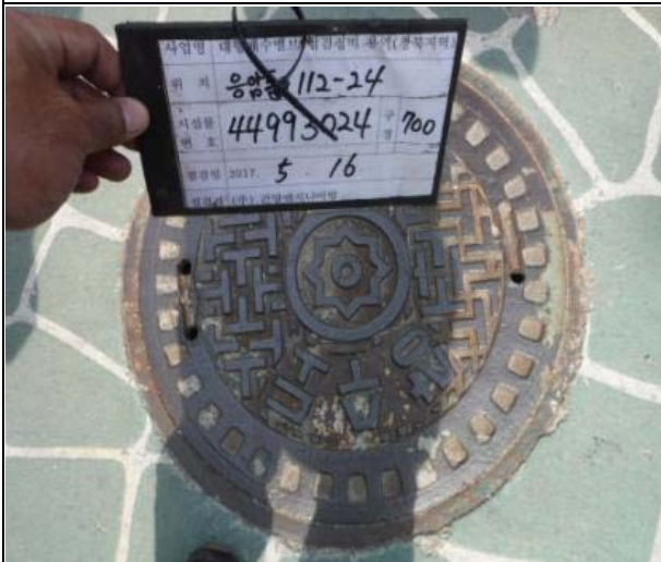
외부 포장 균열
