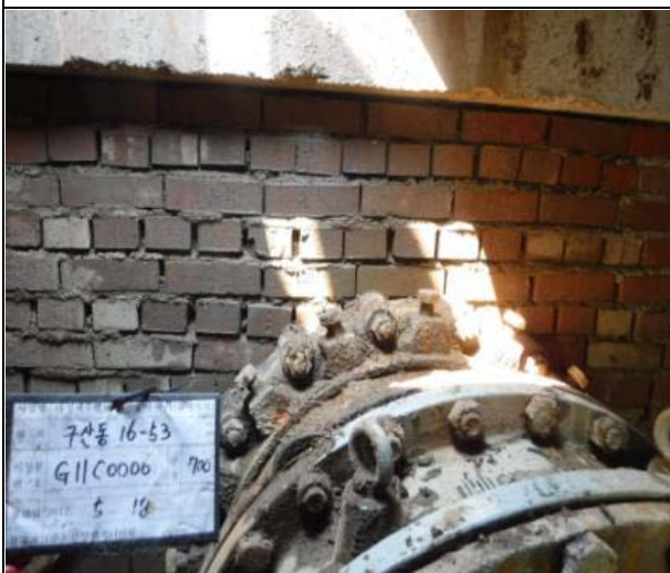
내부 벽체 균열
