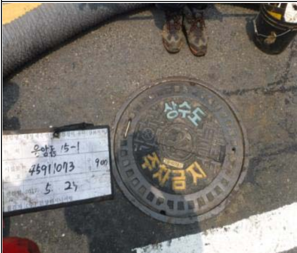
외부 포장 균열
