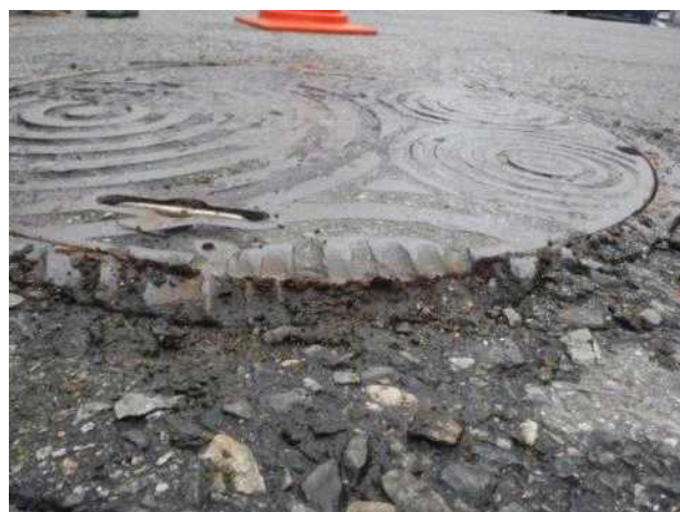
주변포장과의 단차 및 파손
