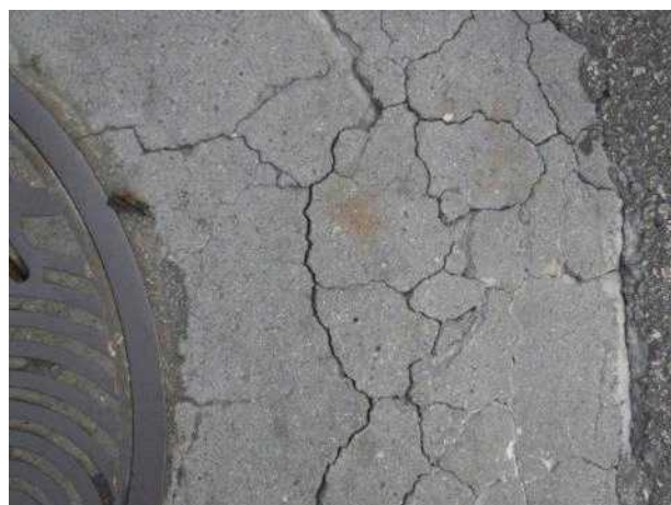
주변포장 망상균열 및 비산
