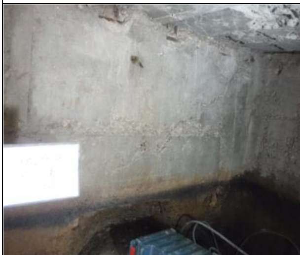
내부 벽체 균열
