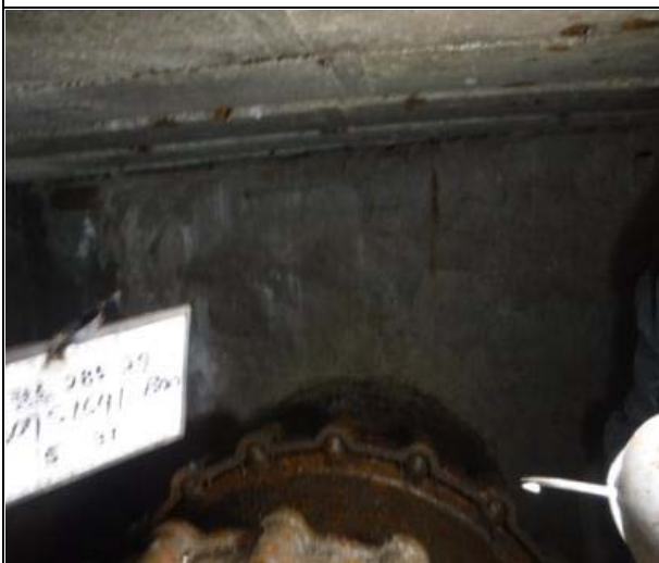
내부 벽체 균열
