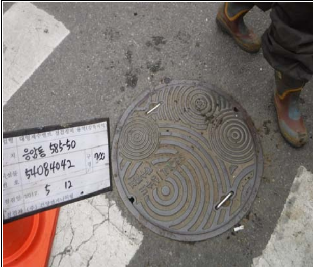
외부 포장 균열
