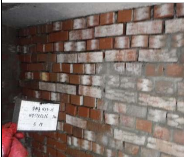
내부 벽체 균열
