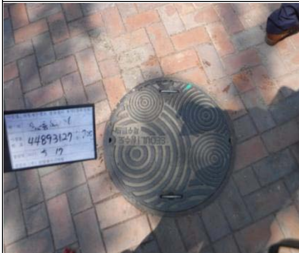
외부 포장 균열
