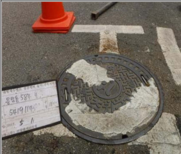
외부 포장 균열
