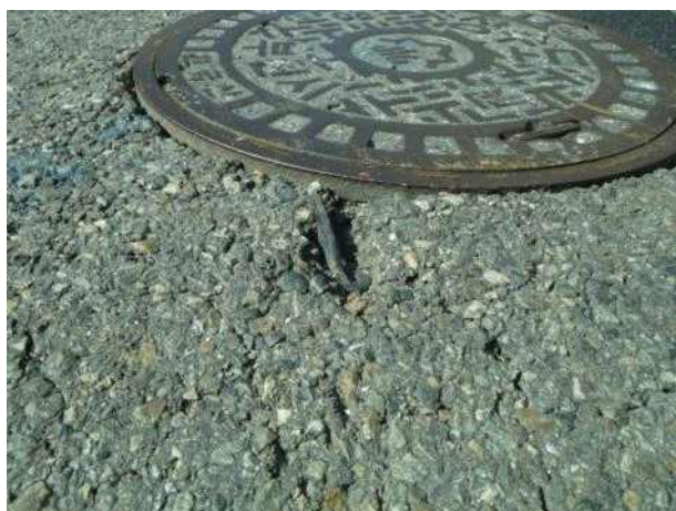
균열 및 비산
