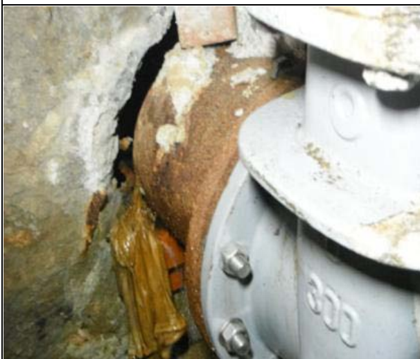
내부 벽체 균열
