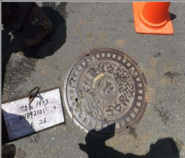
외부 포장 균열
