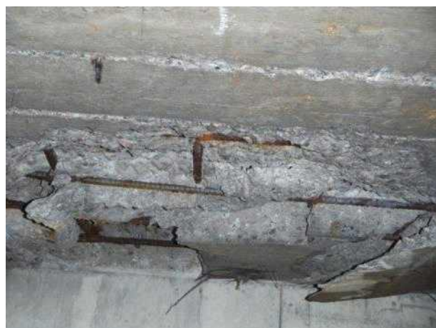
파손 및 철근노출
