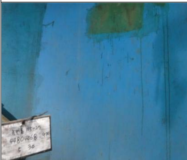
내부 벽체 균열
