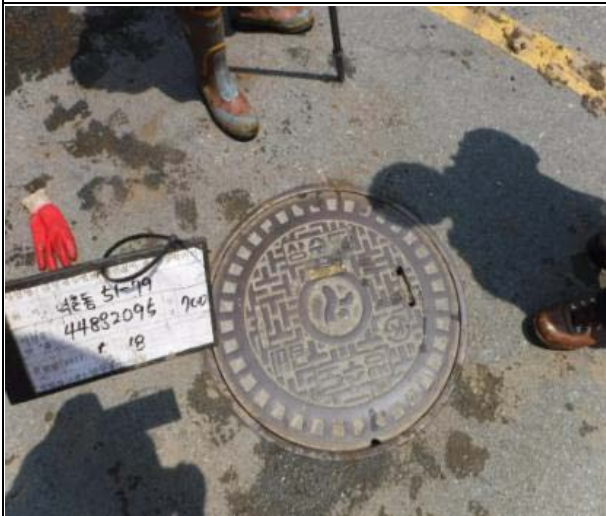
외부 포장 균열
