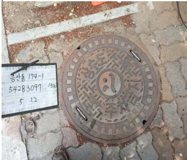
외부 포장 균열
