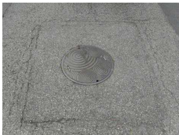
주변포장 균열 및 비산
