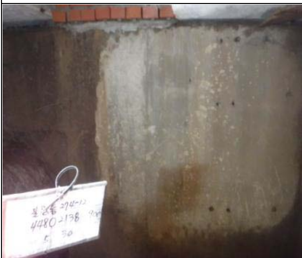
내부 벽체 균열
