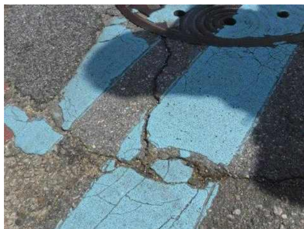
균열 및 비산
