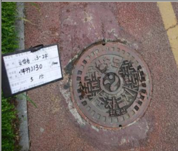
외부 포장 균열
