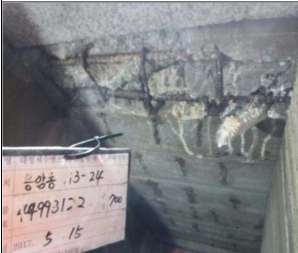
내부 벽체 균열
