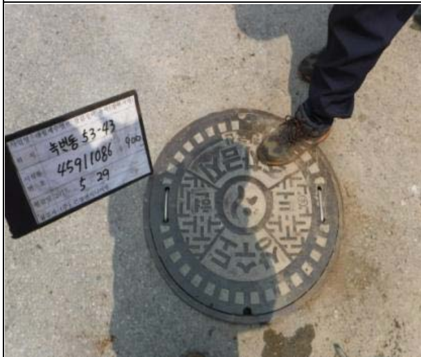
외부 포장 균열
