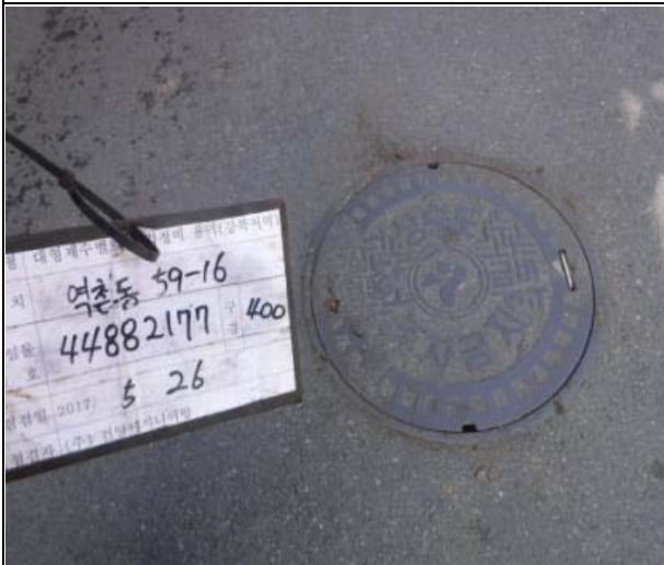
외부 포장 균열
