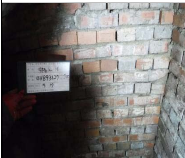
내부 벽체 균열
