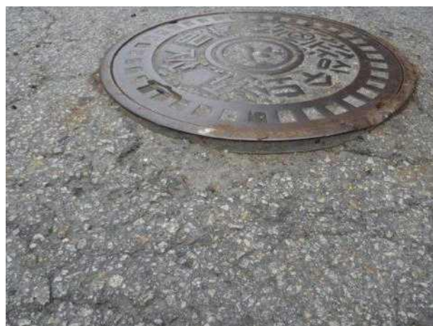
주변포장 망상균열 및 비산
