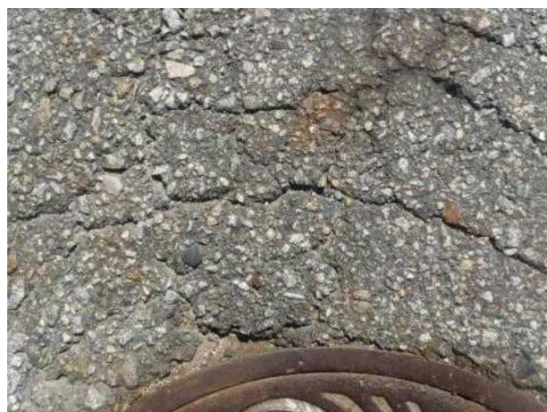
균열 및 비산
