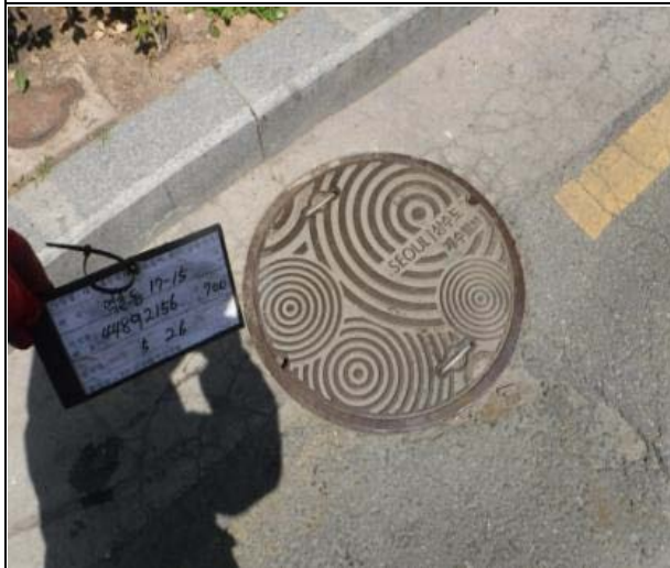
외부 포장 균열
