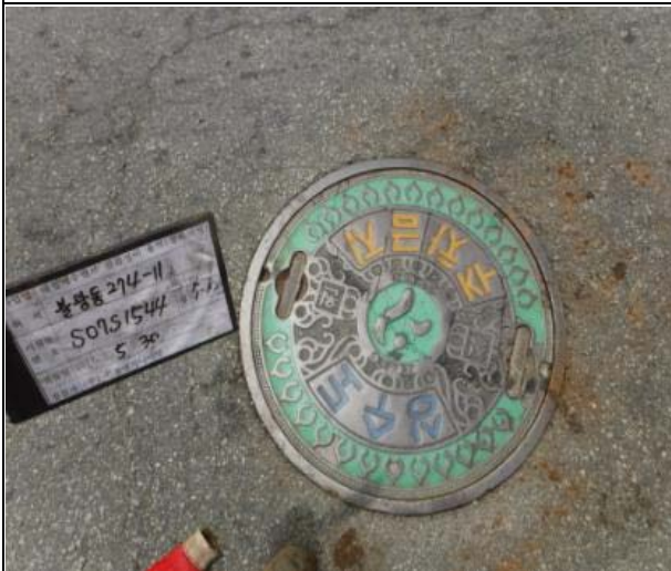
외부 포장 균열
