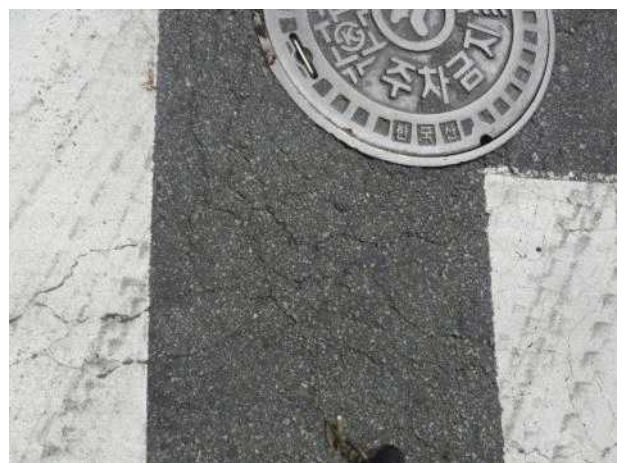
균열 및 틀간 단차
