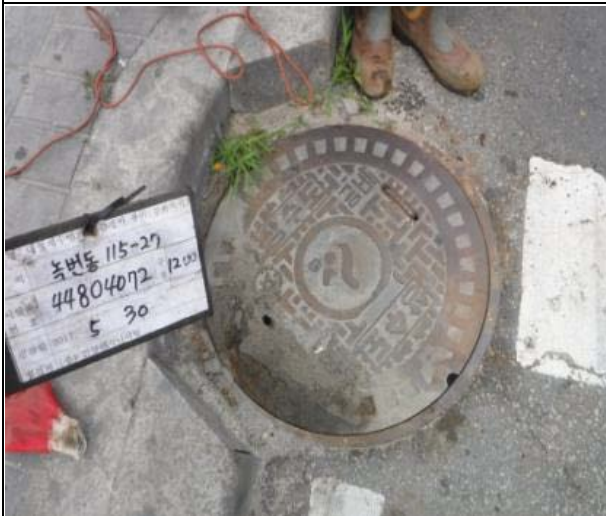
외부 포장 균열
