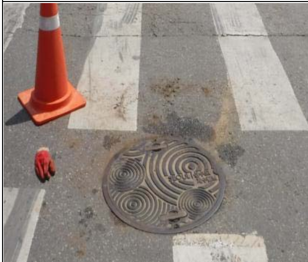
외부 포장 균열
