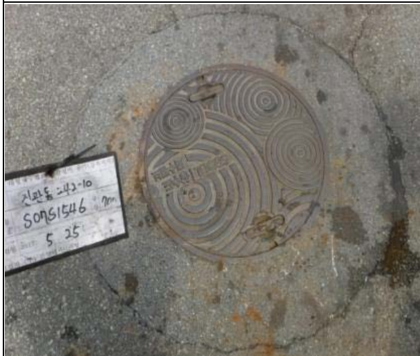
외부 포장 균열
