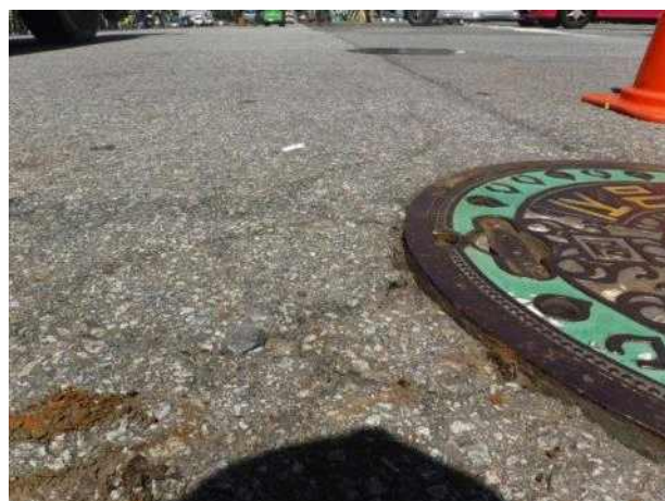
균열 및 비산
