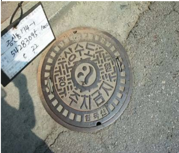
외부 포장 균열
