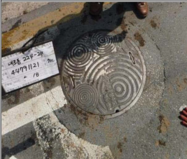
외부 포장 균열
