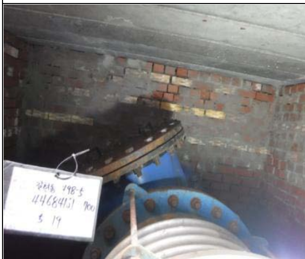
내부 벽체 균열
