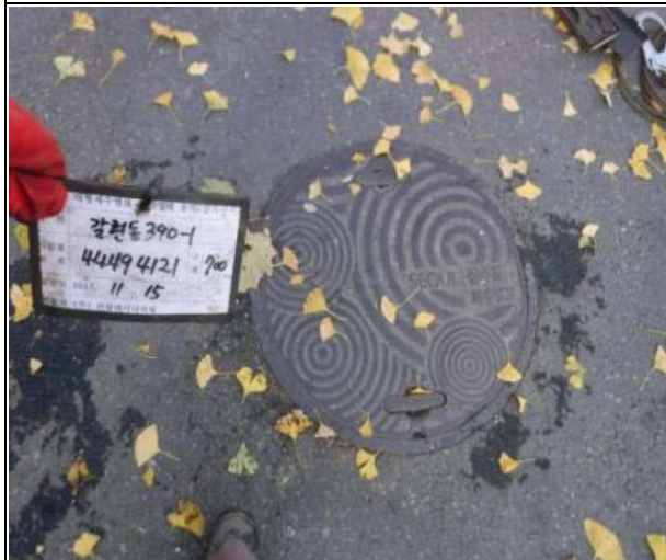
외부 포장 균열
