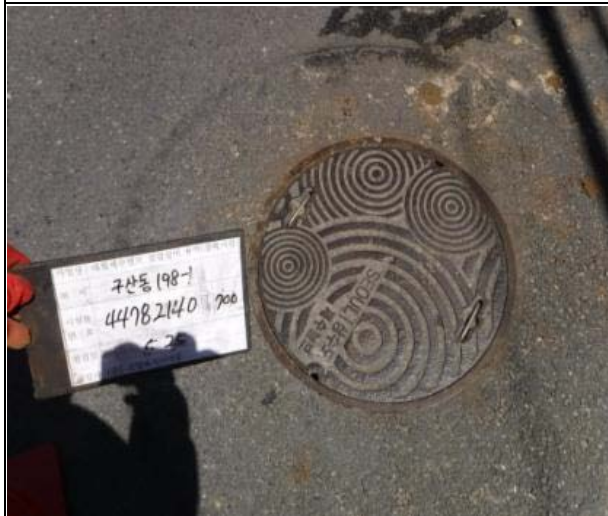
외부 포장 균열
