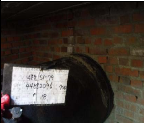
내부 벽체 균열
