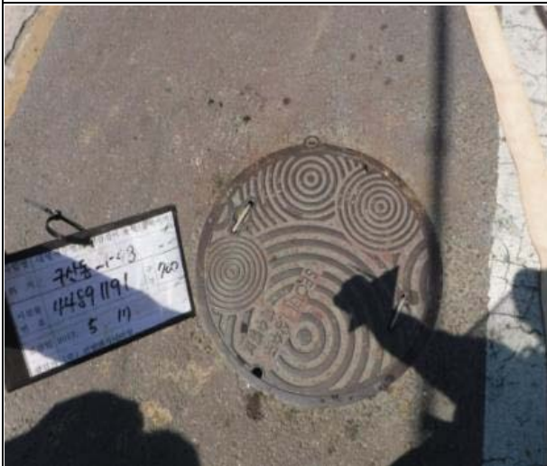
외부 포장 균열
