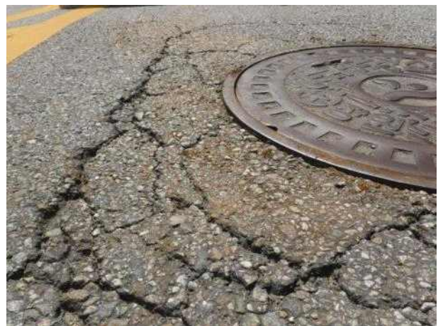
주변포장 망상균열 및 비산
