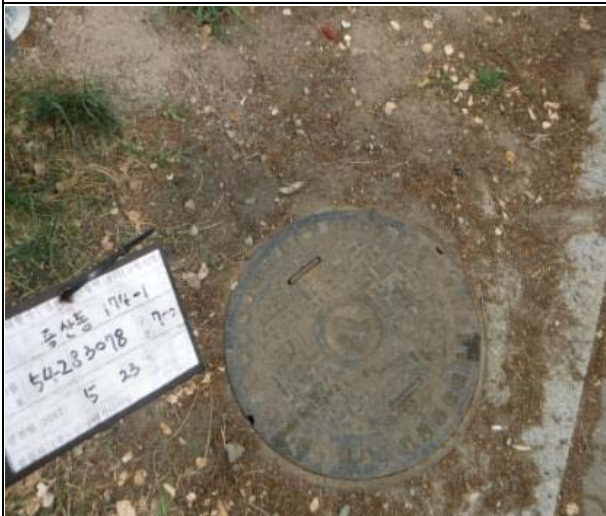
외부 포장 균열
