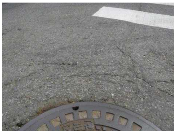
주변포장 망상균열 및 비산
