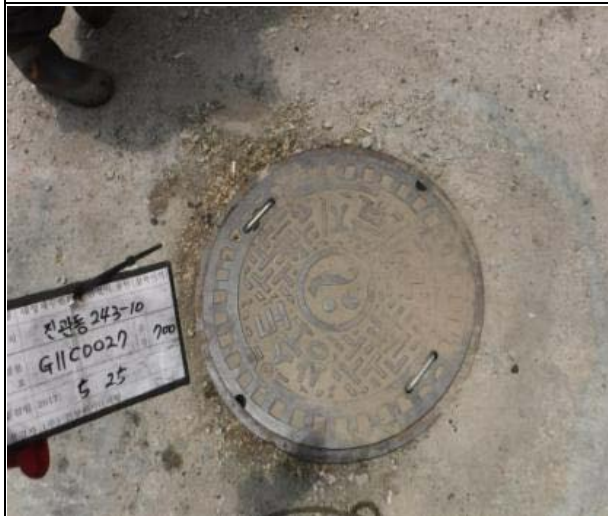
외부 포장 균열
