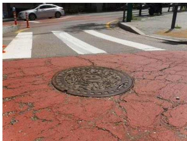
덜컹거림 및 주변포장 망상균열
