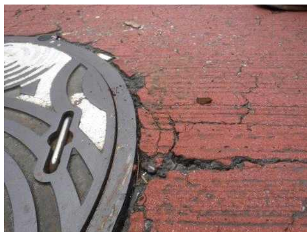
뚜껑부식 및 주변포장 망상균열
