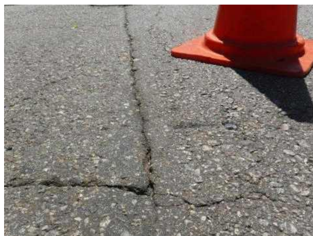
균열 및 비산
