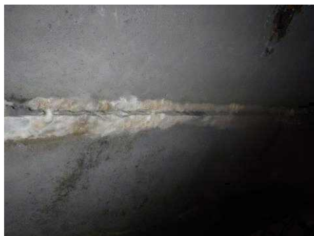
슬래브 재료분리 및 파손, 백태
