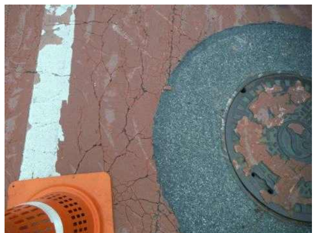
균열 및 비산
