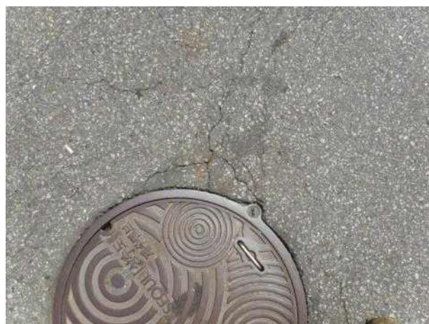
주변포장 균열, 비산 및 단차
