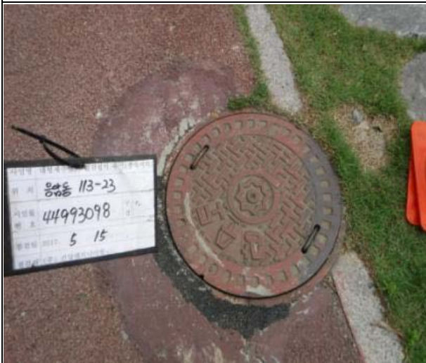
외부 포장 균열
