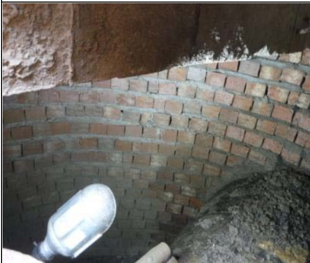
내부 벽체 균열
