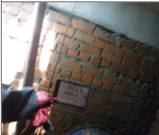
내부 벽체 균열
