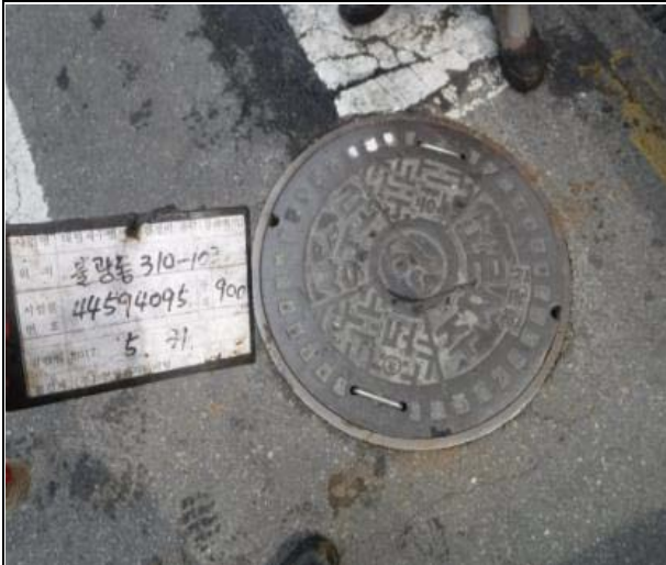
외부 포장 균열
