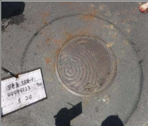
외부 포장 균열
