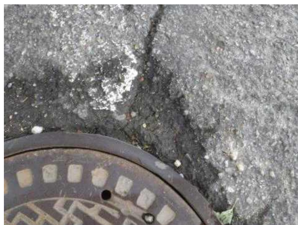
주변포장 균열 및 비산
