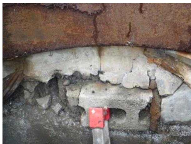
높이조정부 파손 및 충전불량
