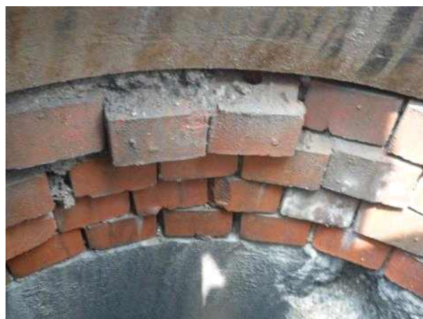
높이조정부 충전불량 및 파손
