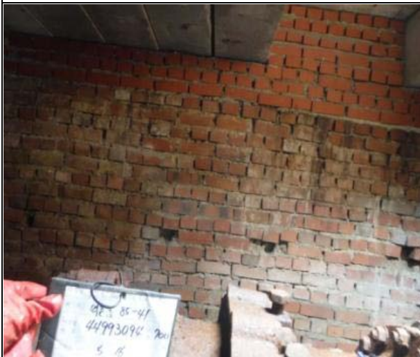
내부 벽체 균열
