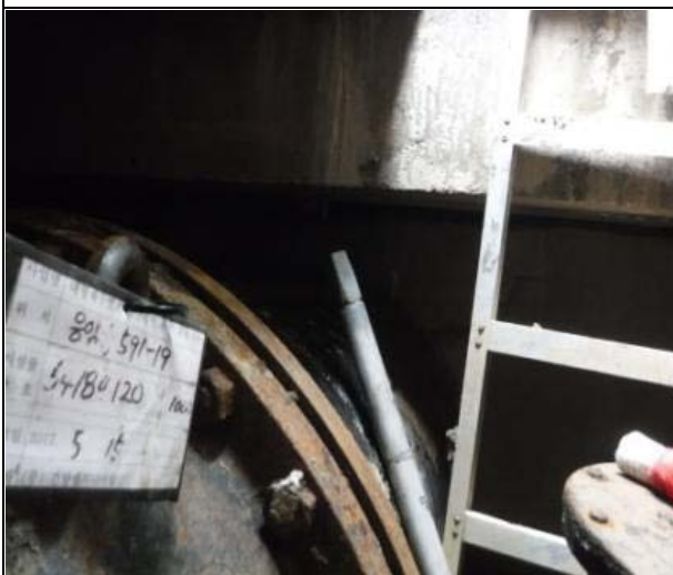
내부 벽체 균열
