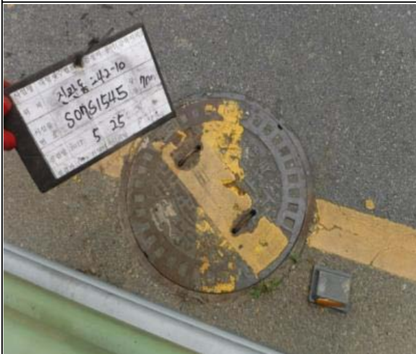
외부 포장 균열
