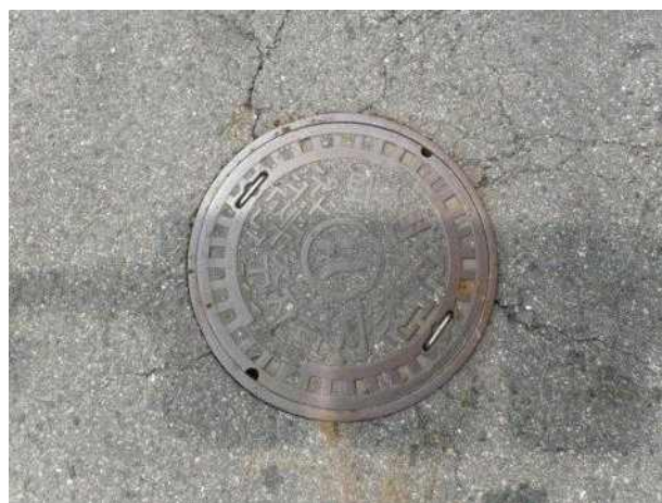
주변포장 다수균열 및 단차
