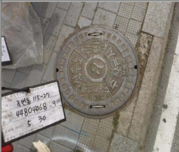
외부 포장 균열
