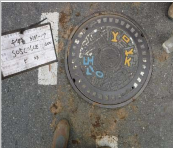
외부 포장 균열
