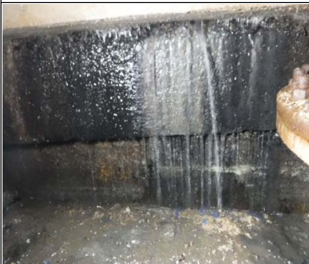
내부 벽체 균열
