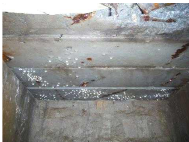
파손 및 철근노출
