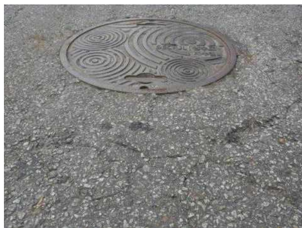
주변포장 망상균열 및 비산
