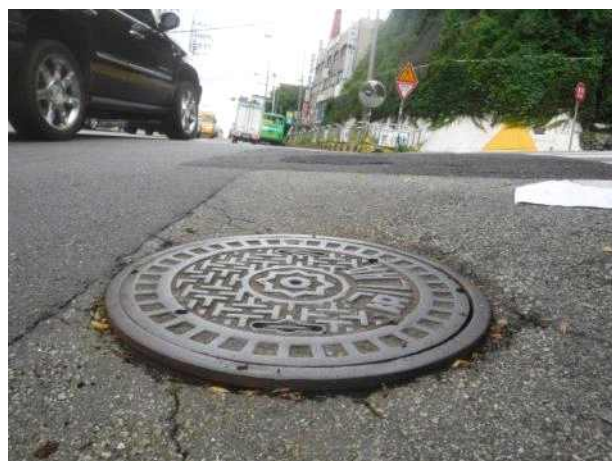
주변포장과의 단차 및 균열
