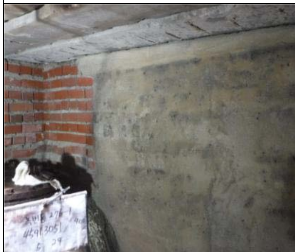
내부 벽체 균열
