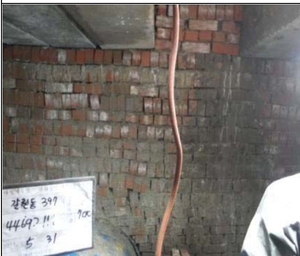
내부 벽체 균열
