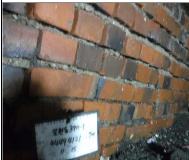
내부 벽체 균열
