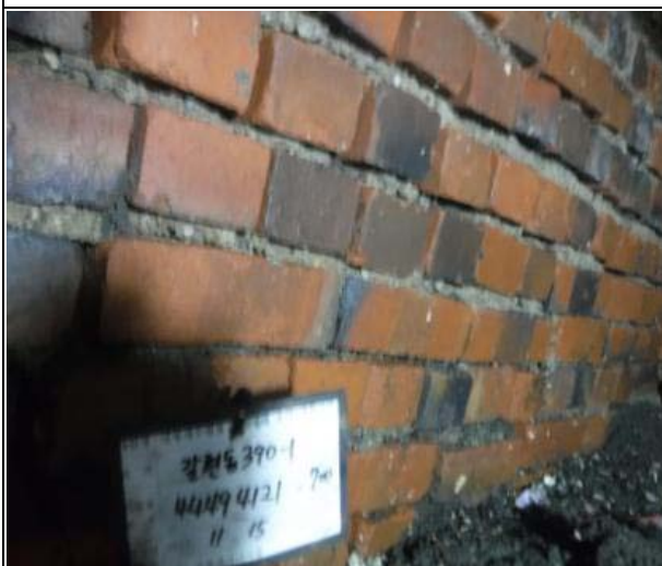
내부 벽체 균열
