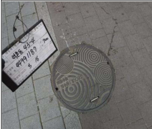
외부 포장 균열
