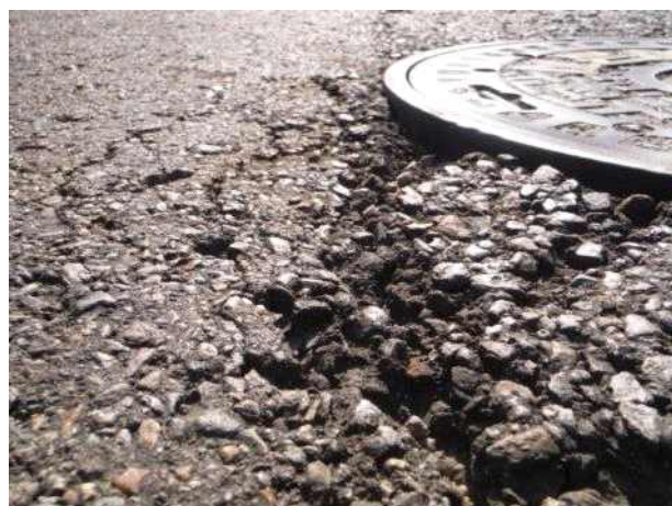
주변포장과의 단차 및 균열
