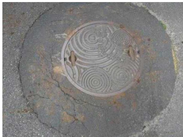
주변포장 망상균열 및 비산
