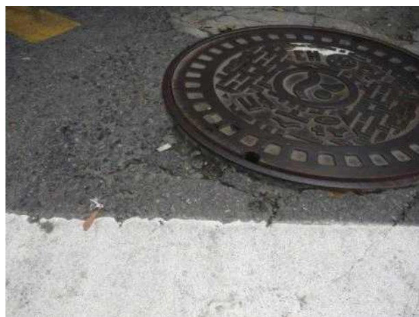
주변포장 망상균열 및 비산
