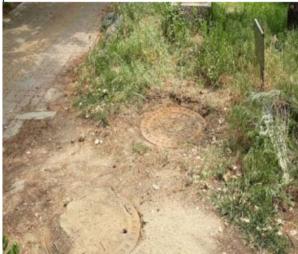
외부 포장 균열
