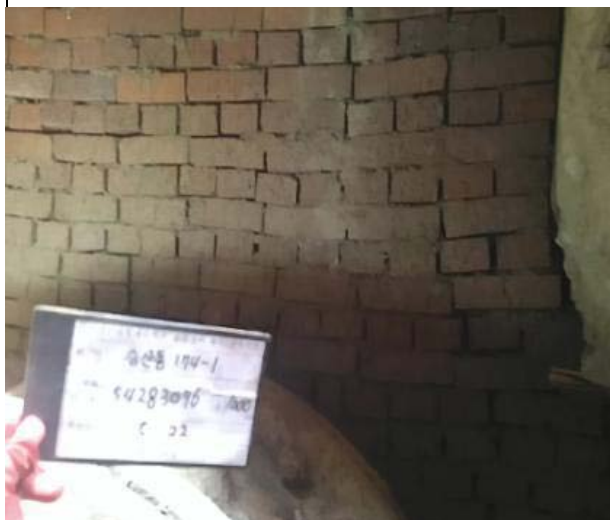
내부 벽체 균열
