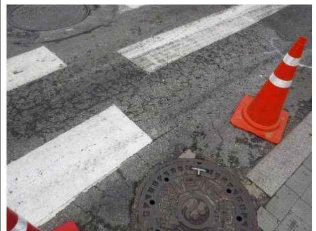
주변포장 망상균열 및 비산
