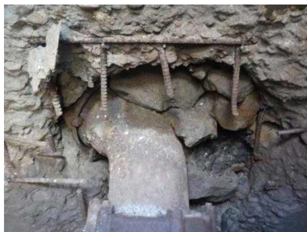
철근노출 및 파손
