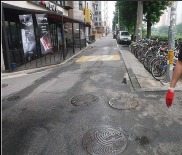
외부 포장 균열
