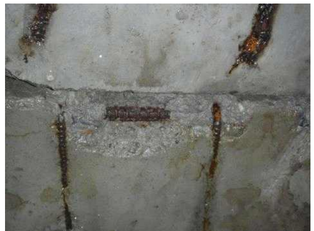
슬래브 철근노출 및 파손
