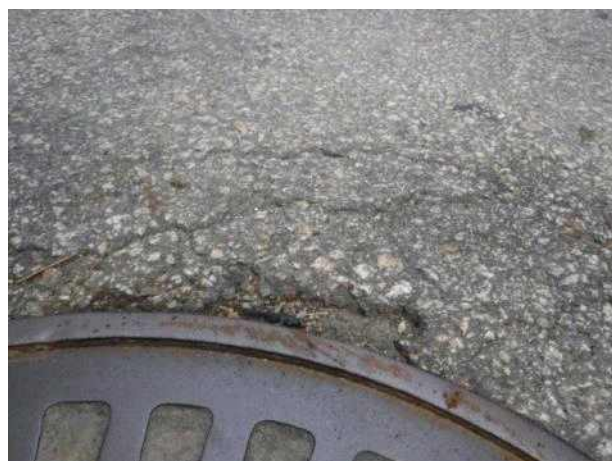
주변포장 균열 및 비산
