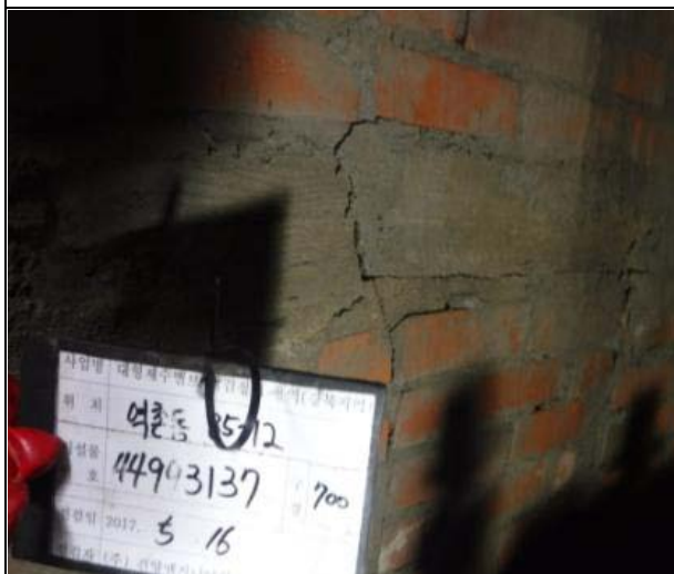
내부 벽체 균열
