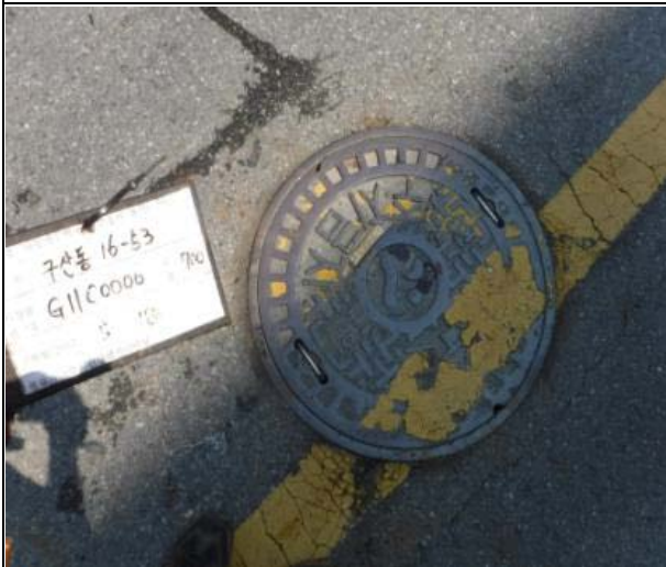
외부 포장 균열
